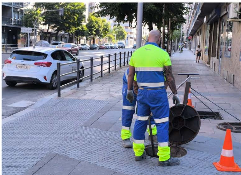
Operarios de Aqualia en el lugar donde se produce la fuga, entre el Paseo de la Estación y Comuneros.
