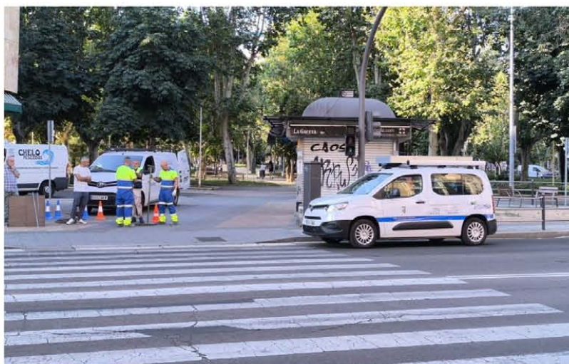
Operarios de Aqualia en el lugar donde se produce la fuga, entre el Paseo de la Estación y Comuneros.
